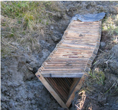
Entwässerung und Böschungsstabilisierung mit einem Holzrostkännel
